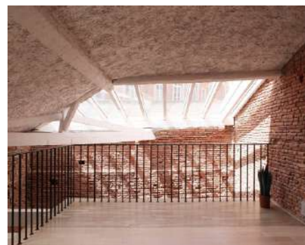
3_ E31 / Toulouse (31) / BAST - Bureau Architectures Sans Titre avec NP2F Crédit photo : BAST
